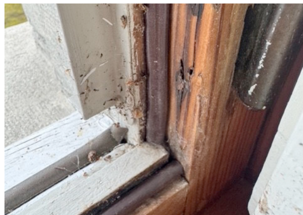
Abb. 52 Verschmutzter Falz mit nachträglich aufgeklebter Dichtung
