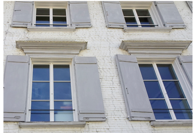
Abb. 43 Absturzstange einfach, Schulhaus, Hermoos 1, Bühler
