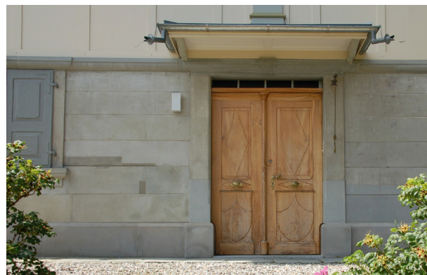
Abb. 11 Haustüre gestemmt, Werdstrasse 34, Heiden
