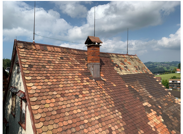
Abb. 42 Ziegeldach mit Reparaturstellen, Ilgenstrasse 9, Speicher
