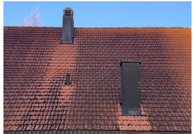
Abb. 46 Ziegeldach mit hellen Stellen unter Kupfer Einfassungen
