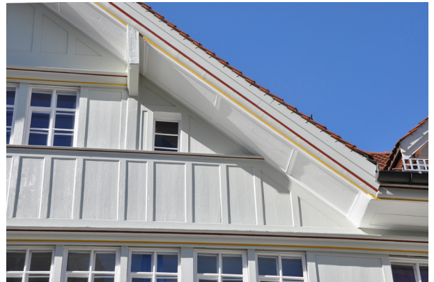
Abb. 22 Ortbrett eingesägt, Gossauerstrasse 1, Herisau
