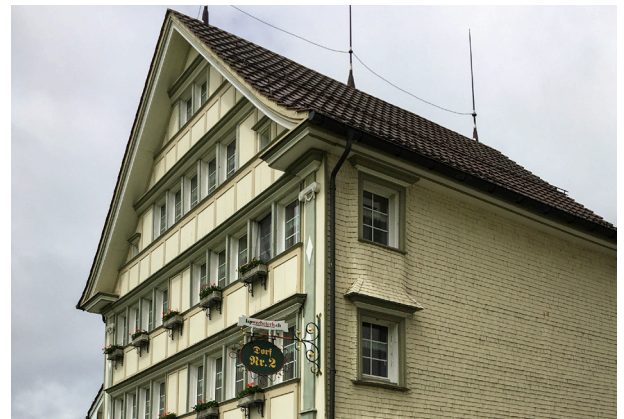
Abb. 23 Dach mit Aufschieblingen/Dachbruch, Dorf 2, Stein
