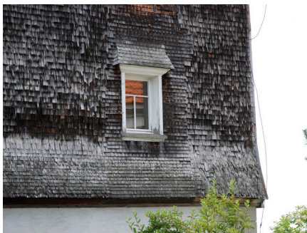
Abb. 27 Reparierte und wieder beschädigte Abwürfe, Holderenstrasse 34, Rehetobel
