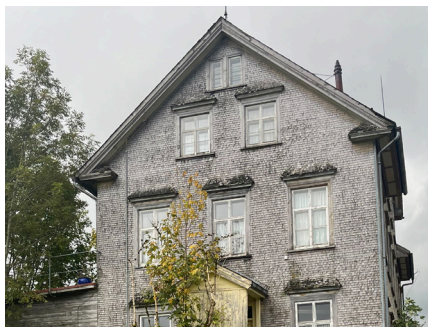
Abb. 29 Abwürfe mit Fäulnisschäden, Midegg 72, Rehetobel
