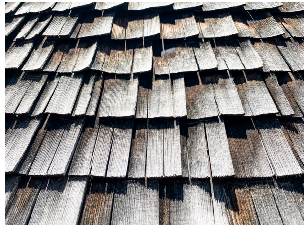
Abb. 17 Schlaufschirm mit verwitterten Dünnschindeln
