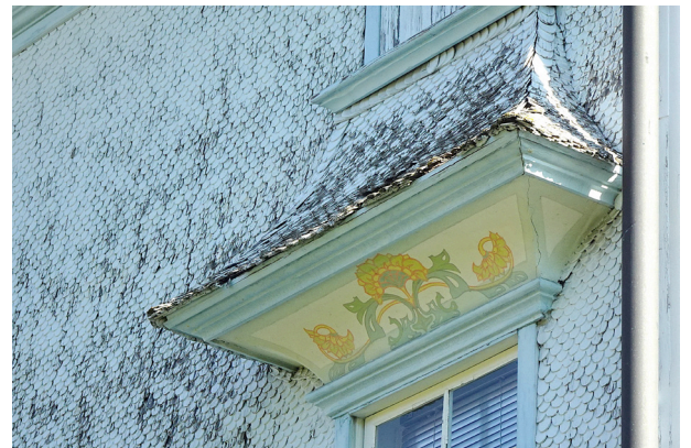
Abb. 9 Gipshohlkehle unter Schindelabwurf mit Fäulnis, Alte Landstrasse 82, Wolfhalden Bildarchiv Denkmalpflege Appenzell Ausserrhoden
