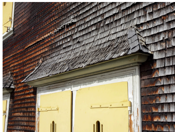
Abb. 25 Fensterabwurf mit Schäden, Oberdorfstrasse 93 Herisau
