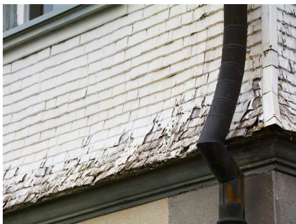
Abb. 28 Sockelabwurf mit Farb- und Fäulnisschäden, Dorf 46, Speicher
