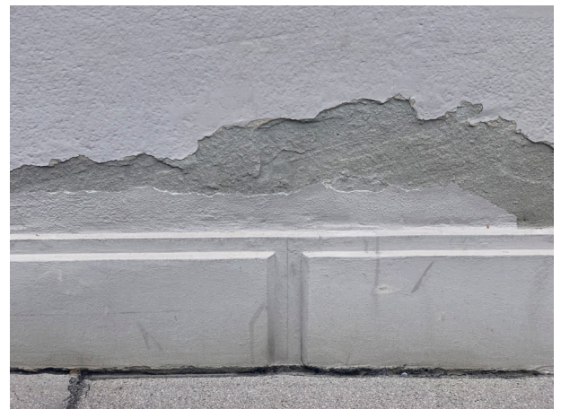
Abb. 27 Schaden über Sockelpartie mit Zementputz
