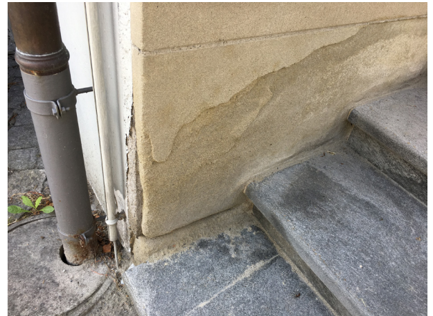
Abb. 19 Treppenstufen aus Gneis mit Streusalzschäden an Sandsteinmauerwerk
