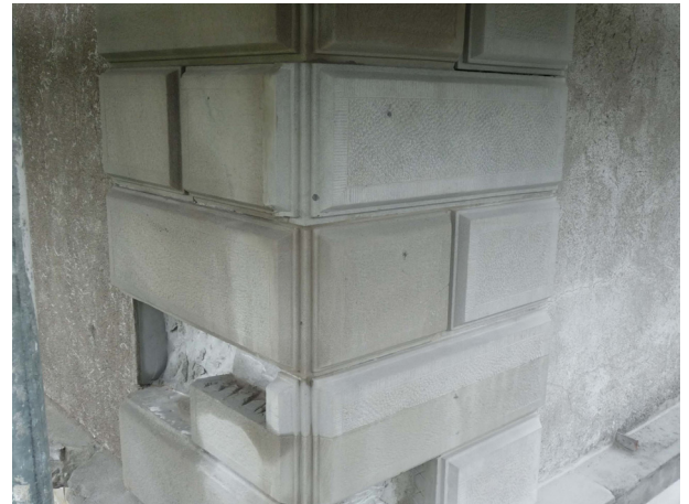
Abb. 26 Sandsteinecke mit Vierungen
