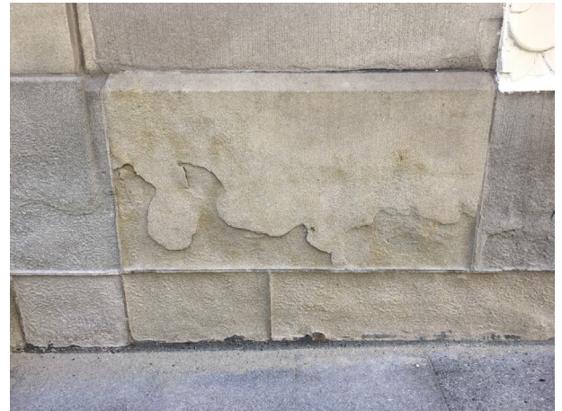
Abb. 21 Sandsteinquader mit Zementfugen und Abplatzungen
