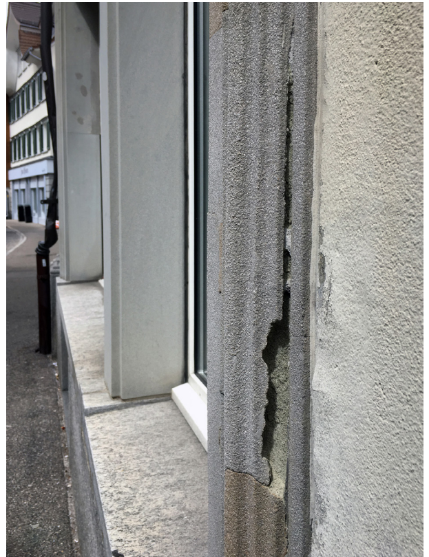
Abb. 23 Fenstergewände mit Reparaturstellen und neuen Schäden
