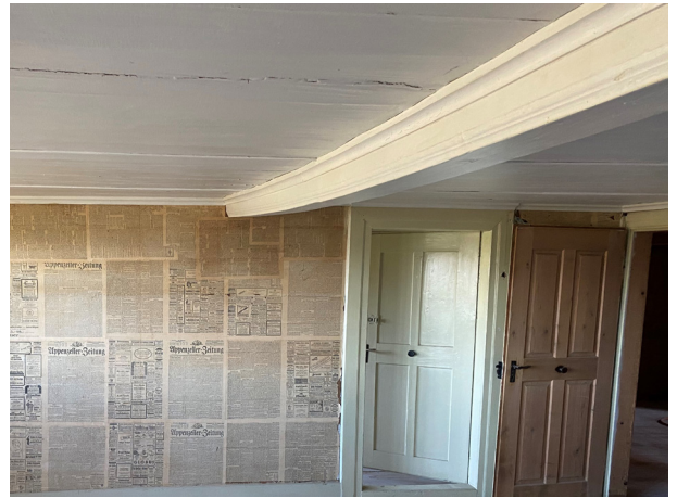
Abb. 22 Unterzug mit sichtbarer Durchbiegung
