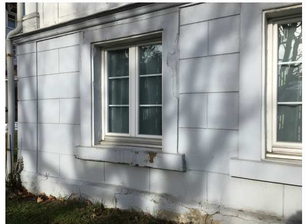
Abb. 22 Sockelpartie mit Dispersionsanstrich, beschädigt
