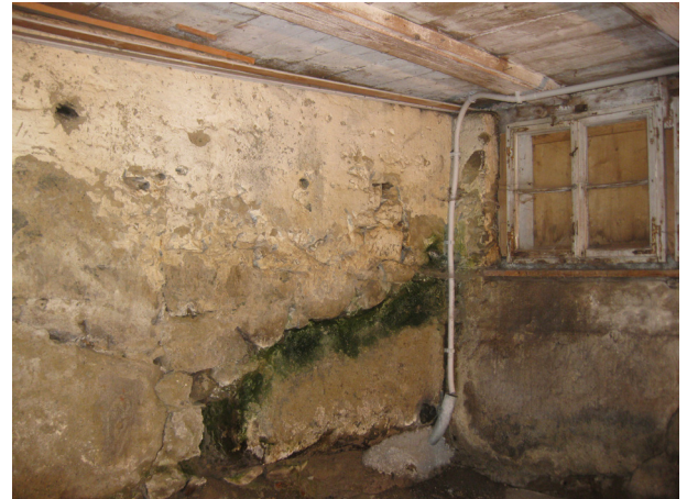
Abb. 2 Sockelmauer mit Feuchtigkeitsschäden
