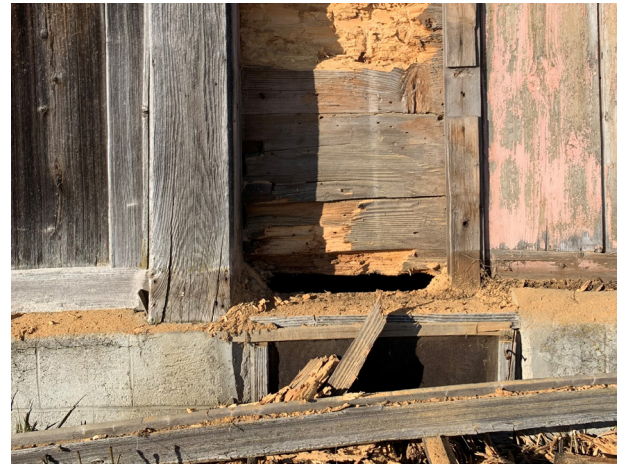
Abb. 21 Vorbetonierung Kellermauerwerk, Schwelle verfault
